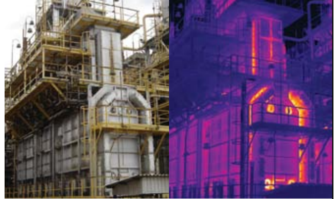
연소실 외판의 표면이나 연도를 열화상 기술로 촬영하면 내부 수압 파쇄 손상으로 인해 과열된 부분을 잡아 낼 수 있습니다.
